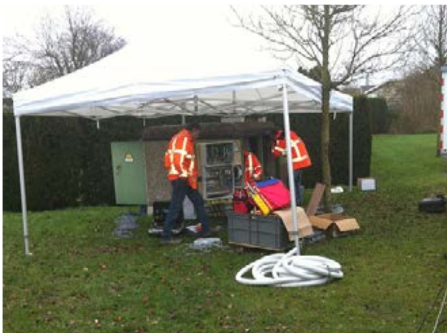
Figuur 7: Installatie van het slim net in Lochem [2]
