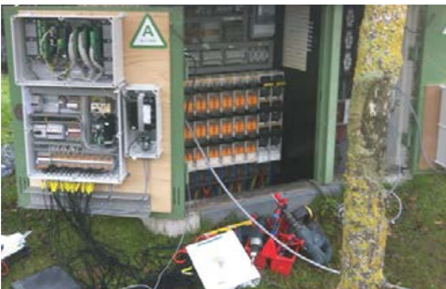
Figuur 5: Installatie van het slim net in Lochem [2]
